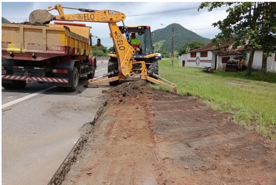
Figura 4.2 Via Lagos - Acostamento - Rep Superficial - KM 17+800 Sul
