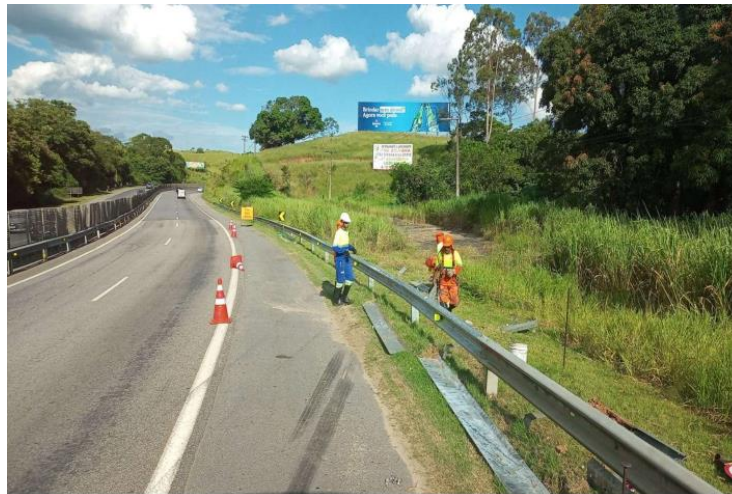
Figura 4.5 Via Lagos - Dispositivo de Segurança - Km 10+600 Norte
