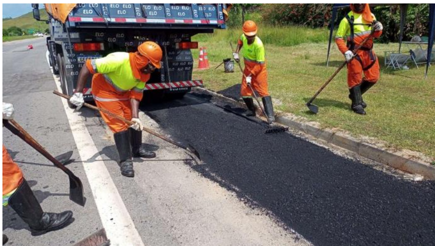
Figura 4.3 Via Lagos - Acostamento - Rep Superficial - KM 14+300 Sul
